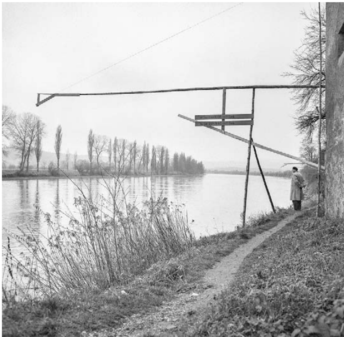
97 Bauprofile für den Staudamm des geplanten Kraftwerks Koblenz-Kadelburg bei Rietheim, 1957. Gegen das Kraftwerk gingen zahlreiche Beschwerden ein, weil die Stromschnellen des Koblenzer Lauffen dadurch zerstört worden wären. Die Bauarbeiten wurden 1966 eingestellt und das Projekt fallen gelassen.
