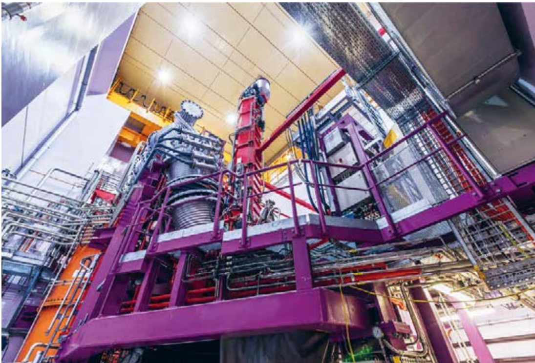
304 Der Plasmaofen im Zwischenlager Würenlingen ist weltweit die erste Anlage, in der leicht radioaktive Abfälle mit einem Hochleistungs-Plasmabrenner bei einigen Tausend Grad Celsius aufgeschmolzen werden. Die Radioaktivität wird durch das Verbrennen nicht verringert, doch das Volumen verkleinert.
