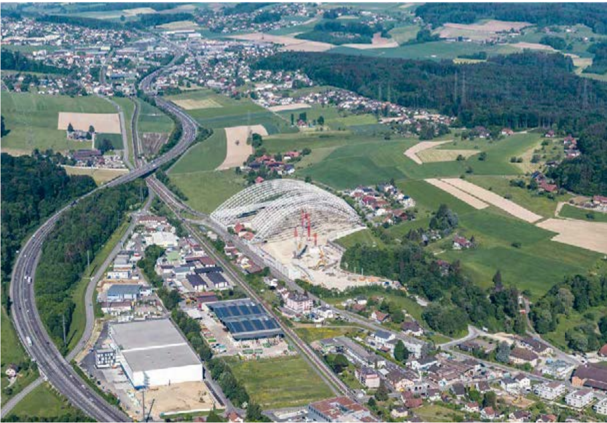
102 Sondermülldeponie Kölliken, 2008. Symbol vergangener Abfallsünden und moderner Altlastenbeseitigung: Für die Gesamtanierung (2006–2020) mussten unter anderem drei luftdichte, unter Unterdruck stehende Hallen und ein Bahnanschluss gebaut werden.
