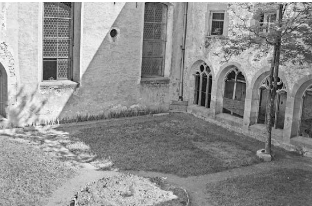
422 Blick in den Kreuzgang des Klosters Muri während der Restaurierungsarbeiten Mitte der 1950er-Jahre. Im verwahrlosten Kreuzgang fehlten die Glasscheiben und es war ein Kaninchenstall dort untergebracht.
