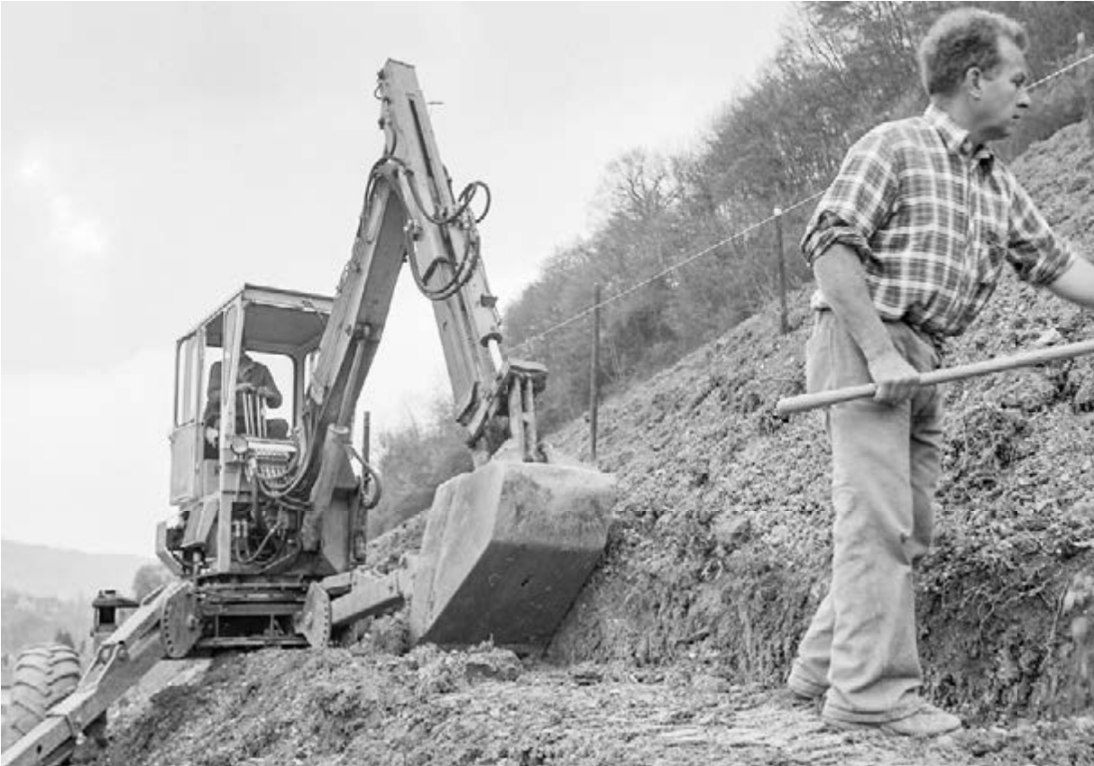
265 Terrassenbau an der Goldwand in Ennetbaden, Ende der 1970er-Jahre. Winzer Bruno Wetzel (1931–2012) liess mit Schreitbagger und Handarbeit terrassieren, um eine rationelle Bewirtschaftung zu ermöglichen. Neu war die Pflanzung der Rebstöcke an der Kante der Terrasse, was als Innovation national ausstrahlte.
